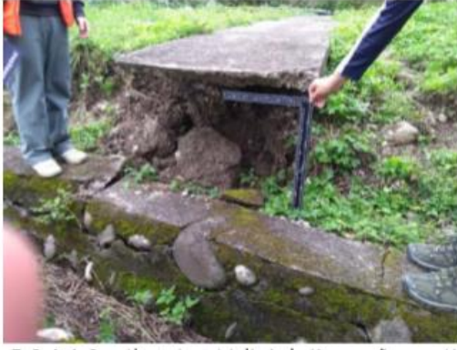
照片 3：華西路崖坡錯動（地調所）
