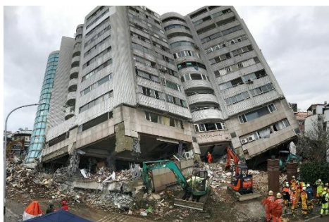
照片 1：國盛六街 41 號大樓倒塌
