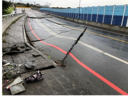
照片 4：七星潭大橋橋面已壓破壞
