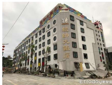
照片 2：統帥飯店倒塌
