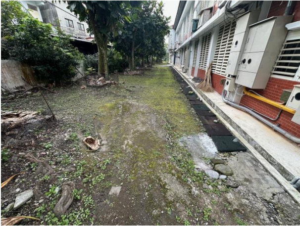
圖 1、教學大樓後方太陽光照片不足，亦滋生青苔。
